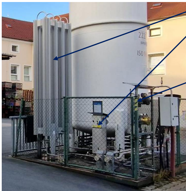
Zásobník CO 2 s ohřívací a redukční stanicí
